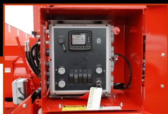
SISTEMA DE CONTROL
