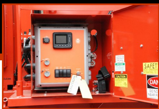
SISTEMA DE CONTROL
