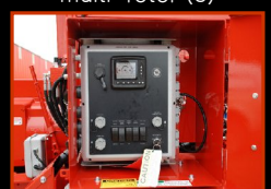
Sistema de control integrado con monitor
